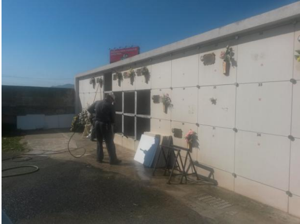
Lavagem do gavetão
